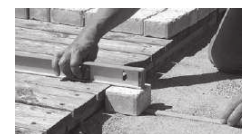
Vérifier la parfaite planéité du support lors de la pose des premiers pavés.
