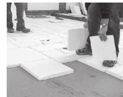
Mise en place des dallages (ici des dalles Castellane pack multiformat) sur lit de sable parfaitement de niveau.
