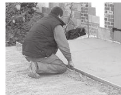
Égalisation de la couche de sable à l'aide de cales de niveau.
