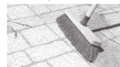
Veiller à bien faire pénétrer le sable dans les joints à l'aide d'un balai, puis compacter pour assurer une bonne pénétration du sable.
